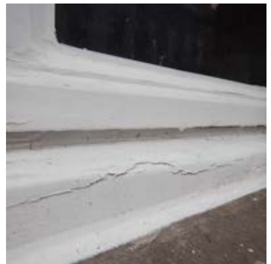
Vleugel [1]-zuid: gebarsten verflaag.
