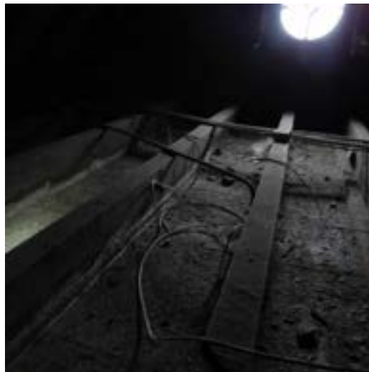
Zolder [5]: slordig kabelverloop.
