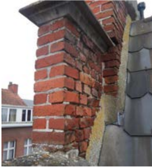
Dak [1a]: uitgespoeld voegwerk aan de achterzijde van een topgevel.
