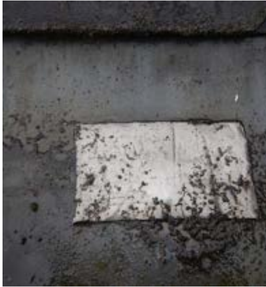
Dak [4]: tijdelijke herstelling.
