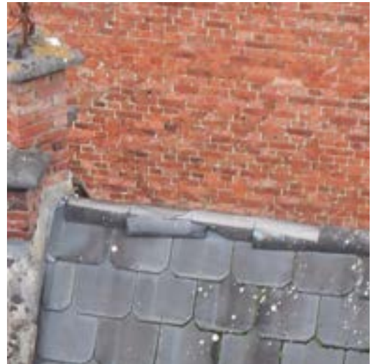
Dak [5]: "herstelde" nokken.
