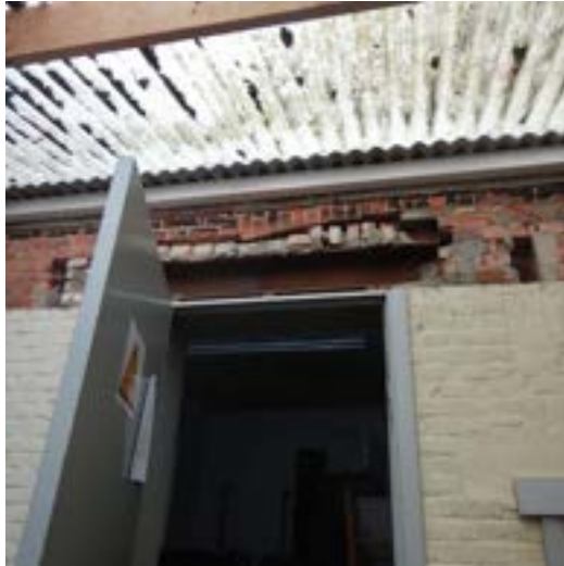
Vleugel [4]-oost: het metselwerk boven de ligger is slordig uitgevoerd.
