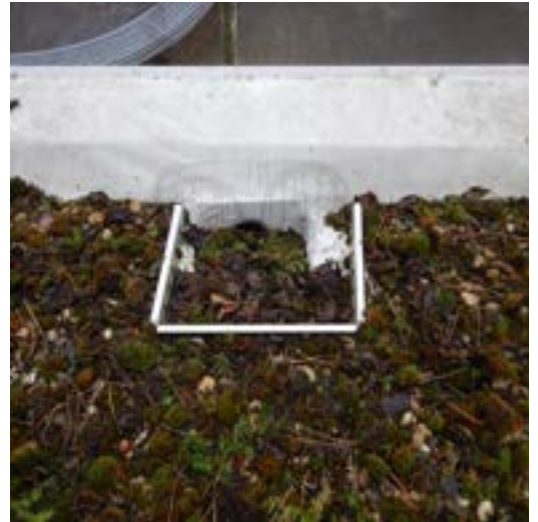
Platte daken nieuwbouw: sterk vervuilde ballast.
