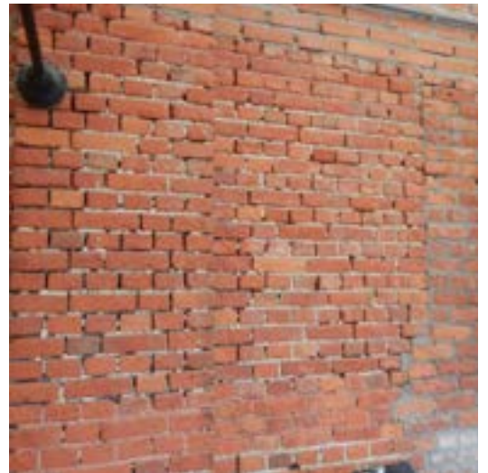
Vleugel [1]-noord: uitgespoeld voegwerk.
