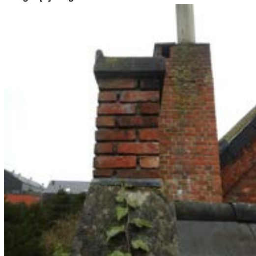
Dak [4]: niet hervoegd topstuk.
