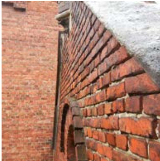
Dak [5]: uitgespoeld voegwerk.
