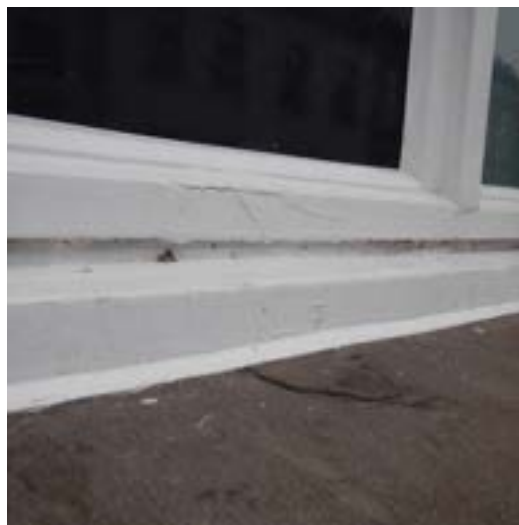
Vleugel [1]-zuid: gebarsten verflaag.
