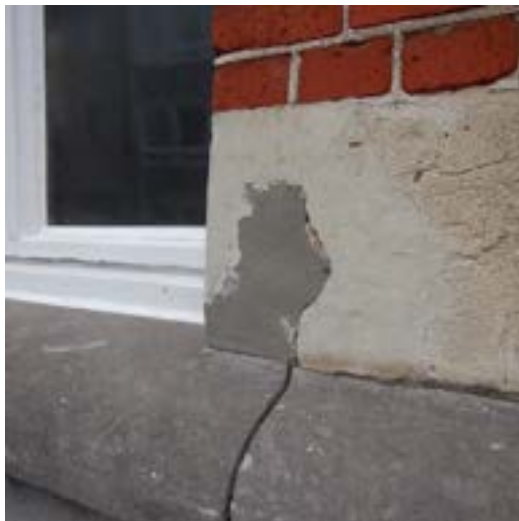
Beschadigd pleisterwerk en herstelling met cementpleister.
