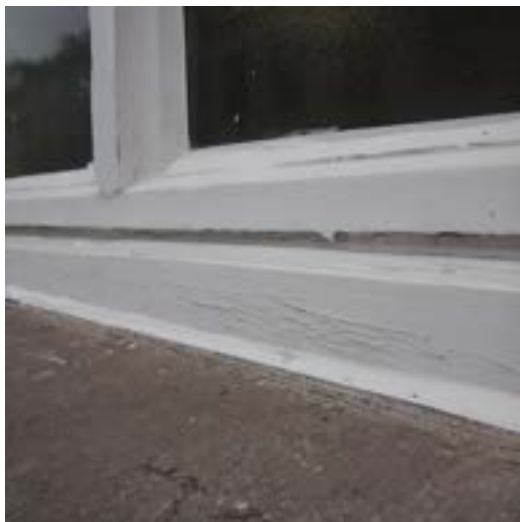
Vleugel [1]-zuid: gebarsten verflaag.
