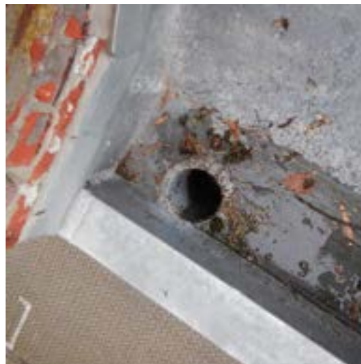
Dak [1]-zuidwest: verstopte afvoer.
