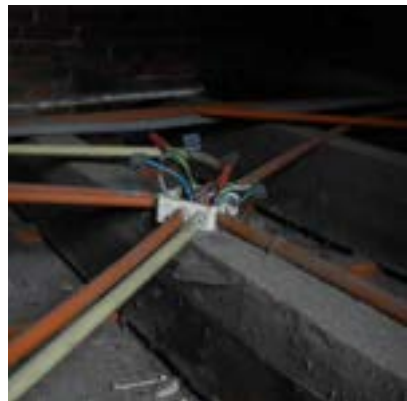
afb. 54: slordige elektrische installatie
