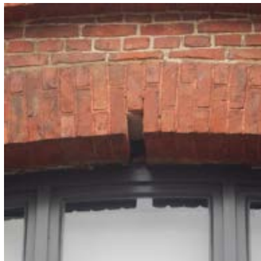
Vleugel [3]: weggevallen baksteen in de strek.
