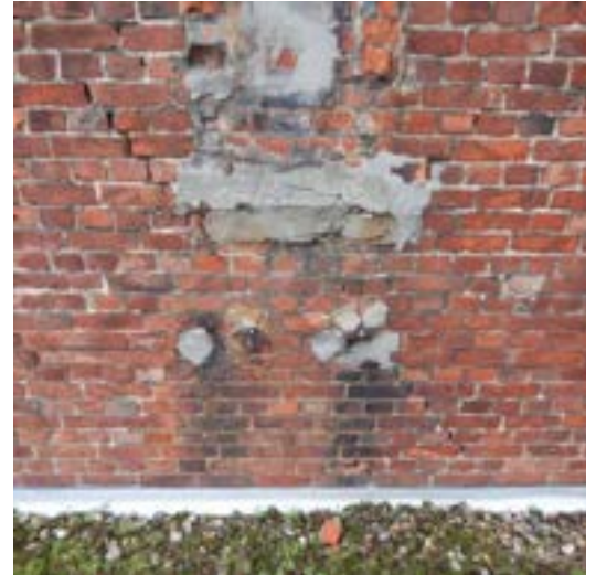
Vleugel [2]-noord: beschadigd metselwerk.
