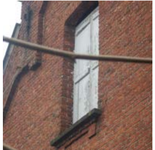
Vleugel [3]: sterk verweerde zolderdeur.
