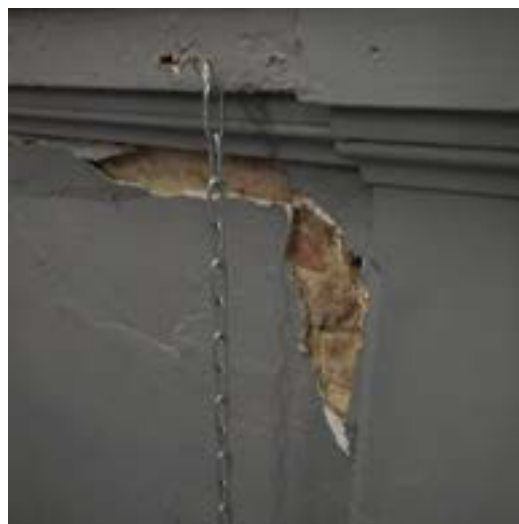
Vleugel [1]-inkomhal: gebruiksschade.
