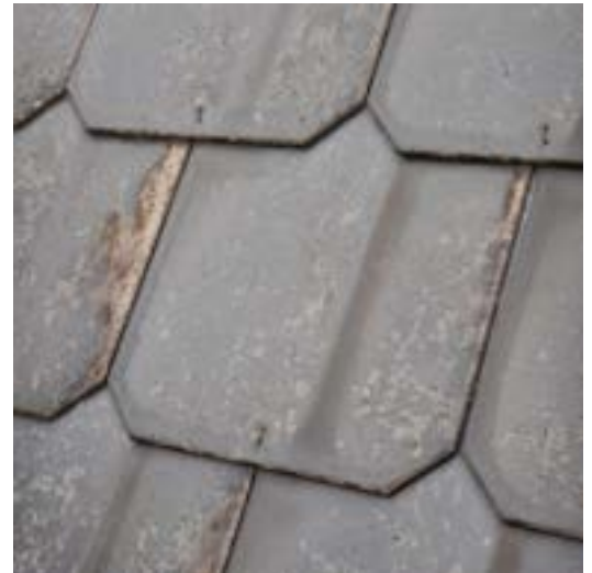
Dak [1]: verweerde vezelcementen leien.
