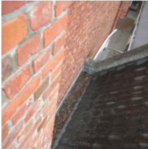
Dak [4]: sterk vervuilde zakgoot.
