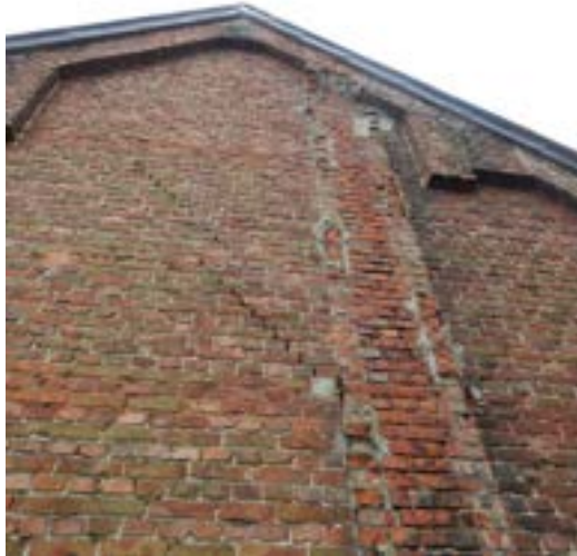
Vleugel [2]-noord: beschadigd metselwerk.
