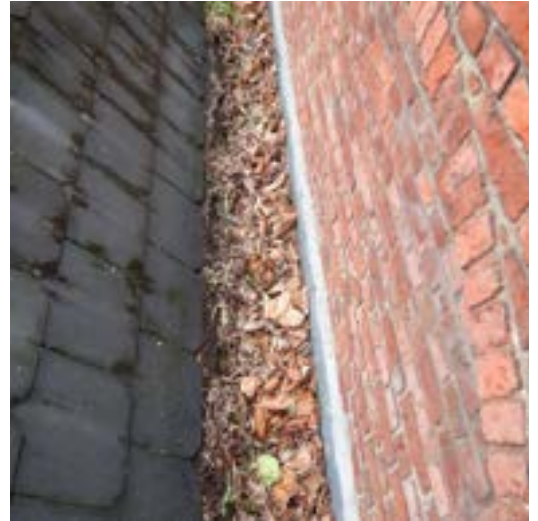
Dak [4]: vervuilde zakgoot.
