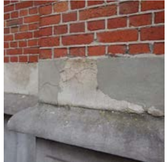
Beschadigd pleisterwerk en herstelling met cementpleister.
