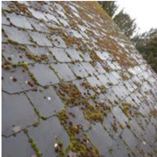
Dak [4]: bemoste leien.
