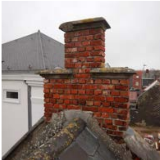
Vleugel [1]-oost: uitgespoeld voegwerk.
