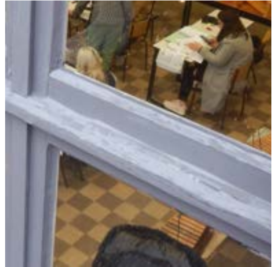
Vleugel [3]: scheuren in de verflaag.
