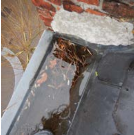
Dak [3]: verstopte afvoer.
