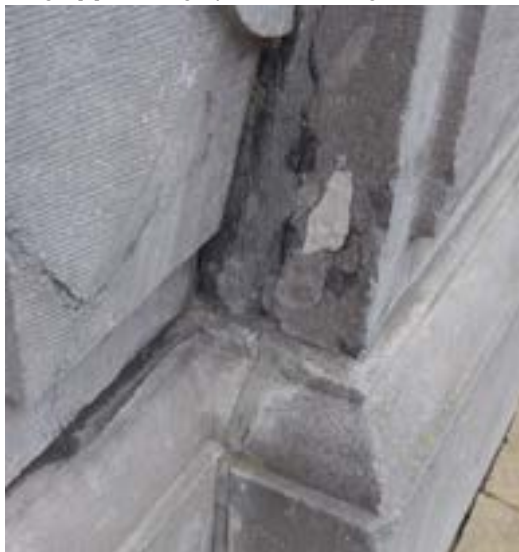
Vleugel [1]-zuid: beschadigde plint.
