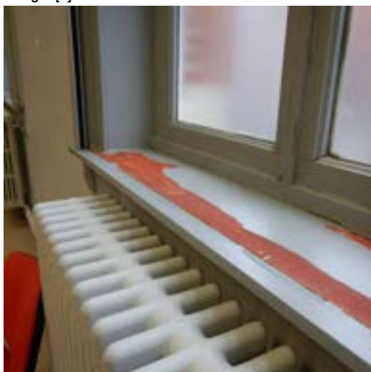
Vleugel [1]-zuid: afbladderende verf op vensterbank.
