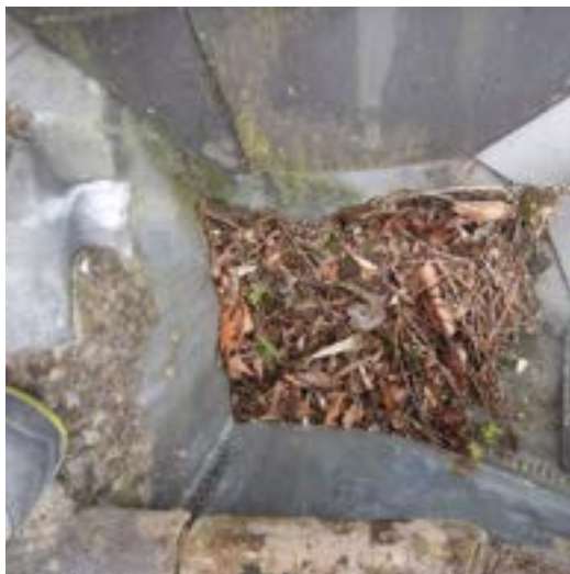
Dak [1a]-zuidoost: vervuilde zakgoot.
