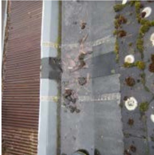
Dak [1]: tijdelijke herstelling.
