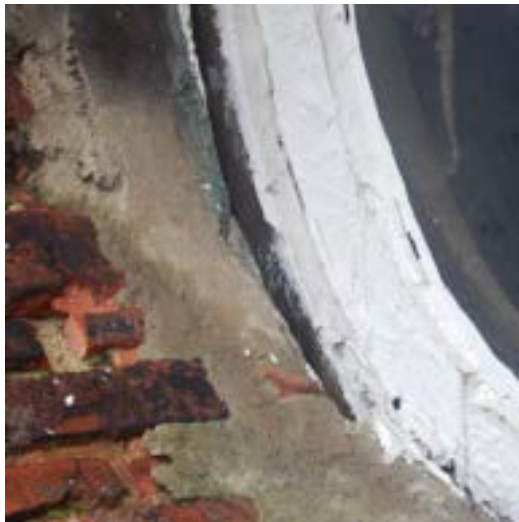
Vleugel [5]: openstaande voeg in de dagkant.
