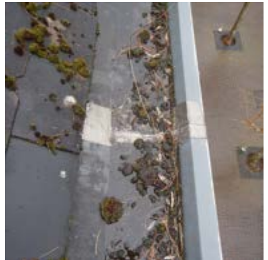
Dak [4]: tijdelijke herstelling.
