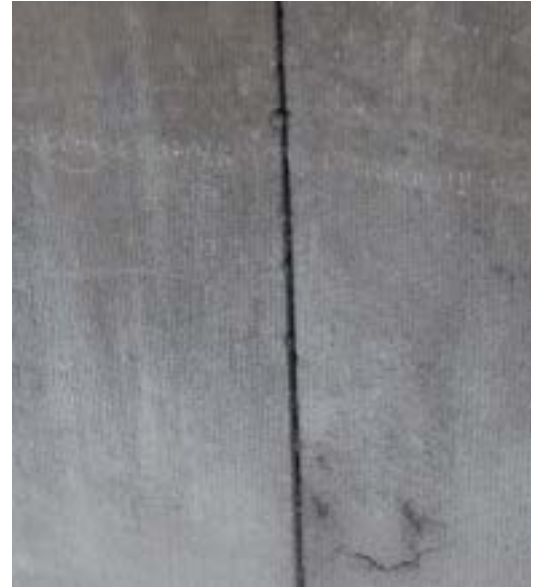
Vleugel [1]-zuid: uitgespoeld voegwerk.
