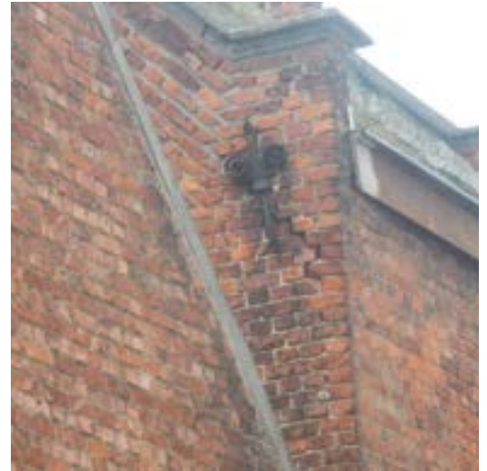
Vleugel [3]: scheurvorming naast het anker.
