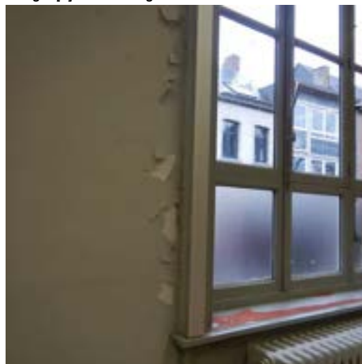
Vleugel [1]: afbladderende verf naast één van de ramen.
