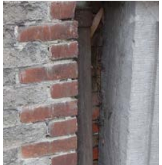
Vleugel [1]-zuid: roestige afvoer.
