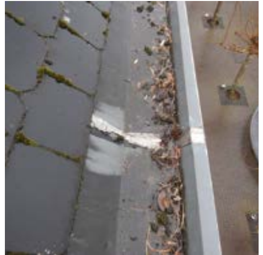
Dak [4]: tijdelijke herstelling.
