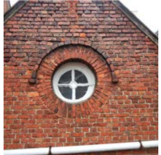
Dak [5]: uitgespoeld voegwerk.
