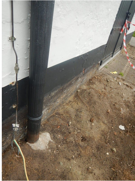
Zuid: beschadiging van de verflaag op de plint.
