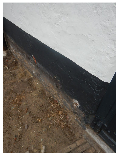
Zuid: beschadiging van de verflaag op de plint.
