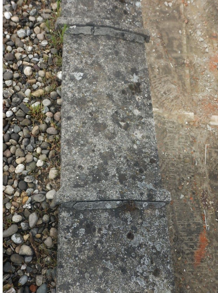
Dak [3]: beschadigde voegen van de dekstenen.
