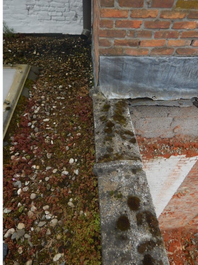
Dak [2]: openstaande loodaansluiting.
