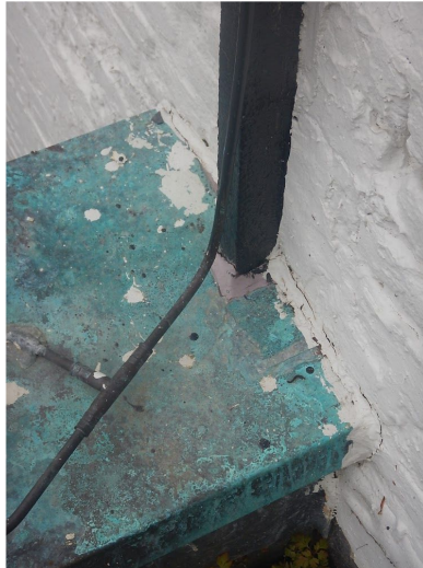
Dak [2]: slordige aansluiting met een muurankers.
