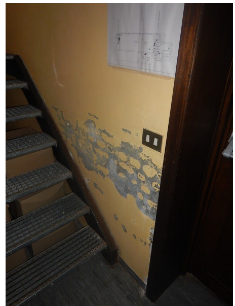
Schade aan het pleisterwerk.
