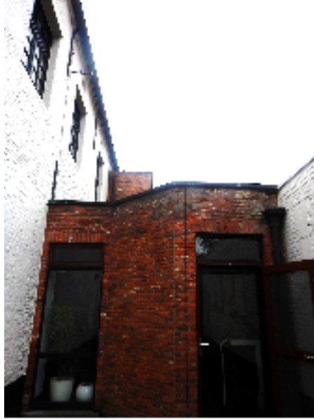
Vleugel [3]: beschadigd metselwerk in de borstwering.
