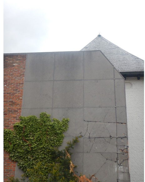
Beschadiging tijdens de afbraak van het buurpand.
