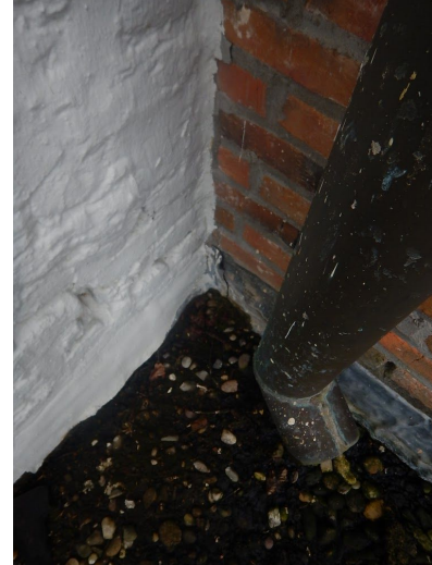
Dak [3]: openstaande loodaansluiting.
