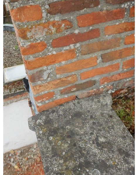
Dak [3]: niet-watertichte aansluiting van de dekstenen met de schoorsteen.
