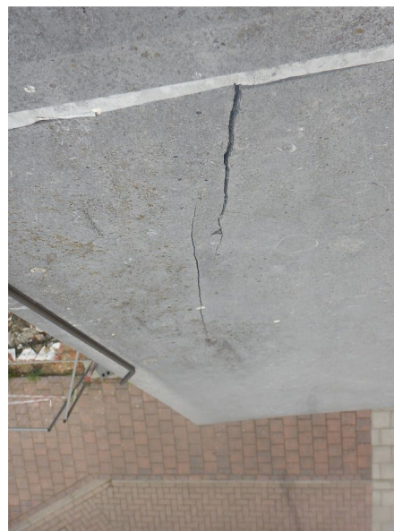
Gescheurde natuurstenen plaat.
