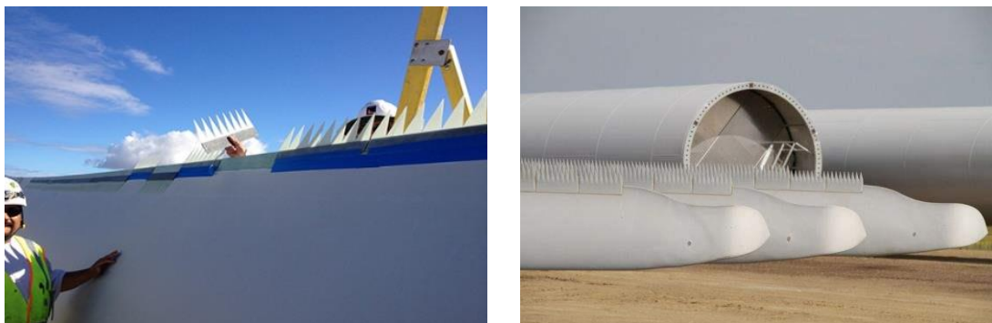
FIGUUR 10 FOTOS VAN AANGEBRACHT SERRATIONS
