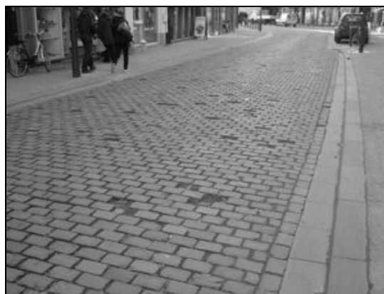
Splijtende kasseien in de Zandstraat
