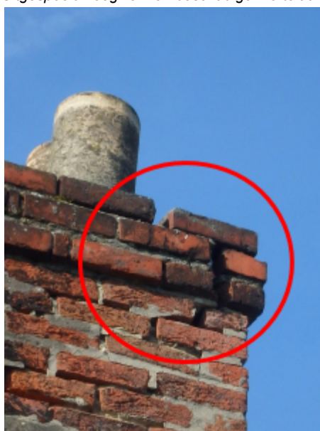
Baksteenmetselwerk ingescheurd en stenen verplaatst
