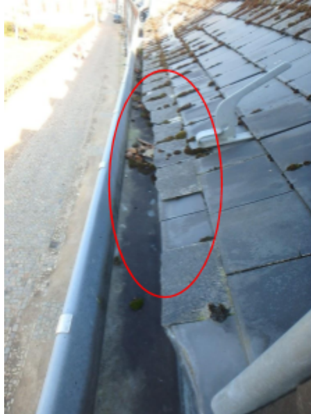
Leien mechanisch beschadigd
