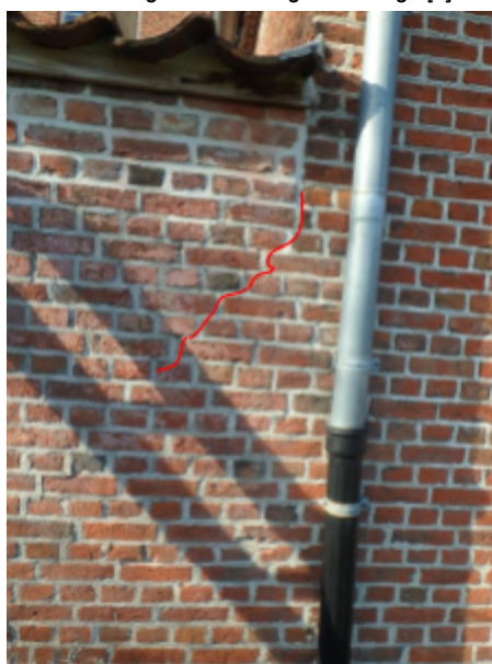
Scheurvorming in aansluiting met woning nr.6
