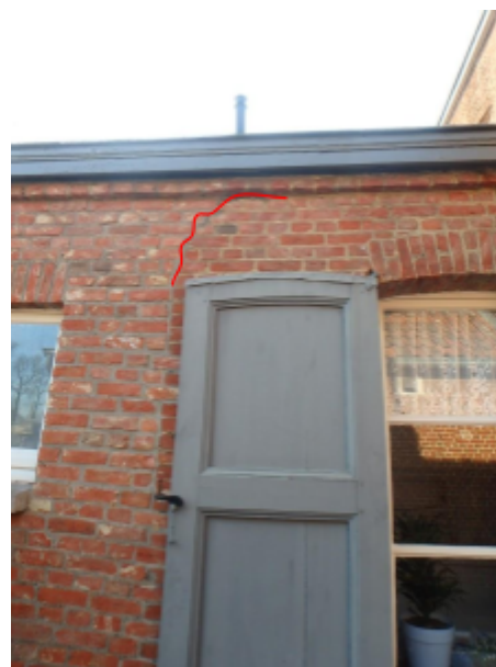
Vleugel [2]-noordgevel: scheurvorming
