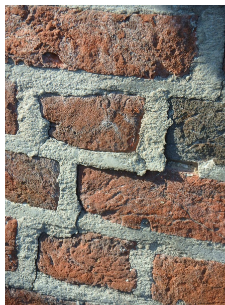
Het voegwerk valt beperkt weg
