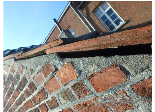
In aansluiting met de achtergevel liggen pannen los
