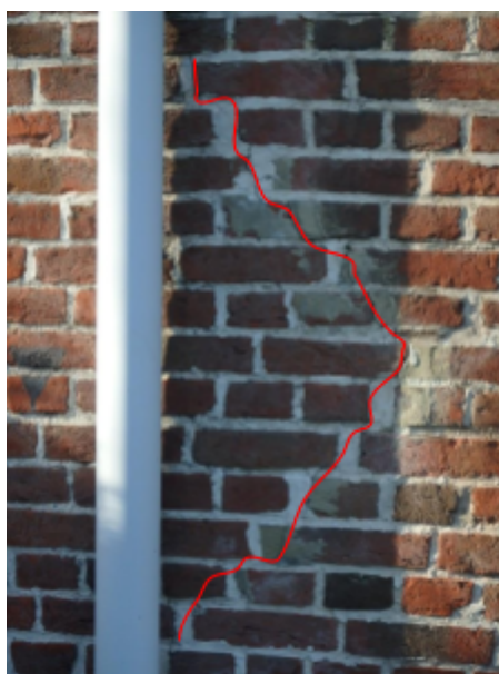
Scheurvorming in aansluiting met vleugel[2]
