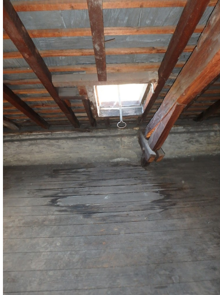
Vochtsporen onder het dakvenster
