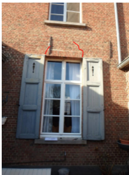
Vleugel [1]-achtergevel: scheurvorming
