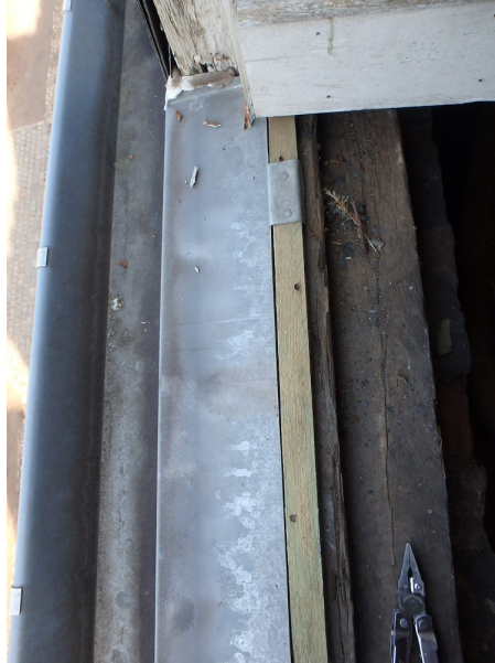
Aansluiting onderaan niet waterdicht
