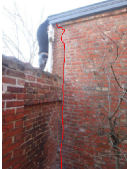
Vleugel [2]- oostgevel/achtergevel is niet ingebonden
