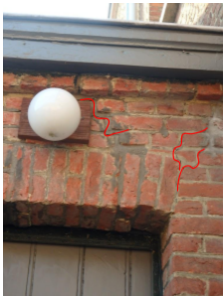
Vleugel [2]-noordgevel: scheurvorming
