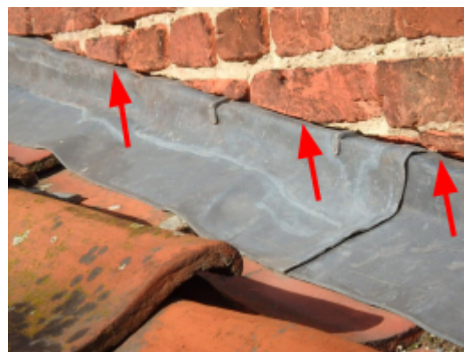
Openstaande voeg van de muuraansluiting
