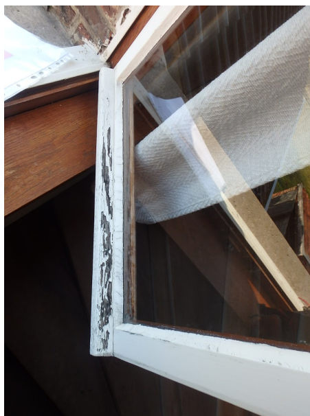
Het schilderwerk van enkele ramen bladdert af
