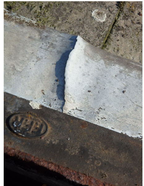
Loodaansluiting met het dakvenster is gescheurd
