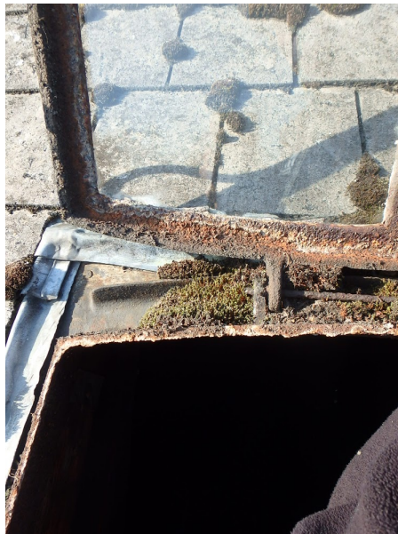
Sterk roestig dakvenster
