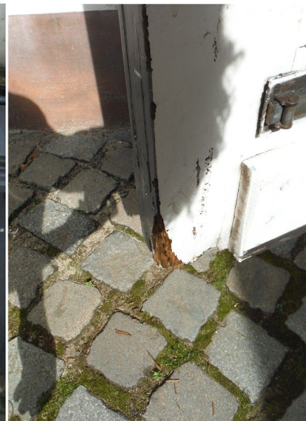
Ingerotte hoek van de deur.
