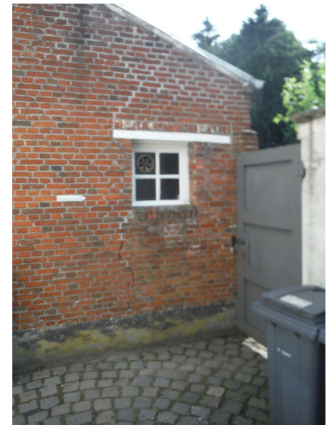
Scheurvorming zuidoostelijke hoek.
