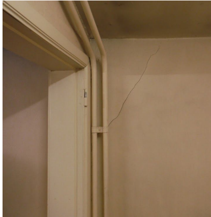
Scheurvorming in de binnenzijde.
