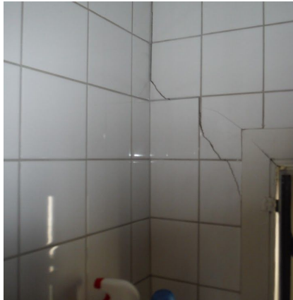
Scheurvorming in de binnenzijde.
