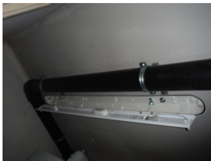
Een loshangende lamp in het branderlokaal.
