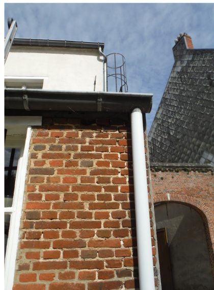
Diagonale scheuren net onder de muurplaat in de noordelijke hoek.
