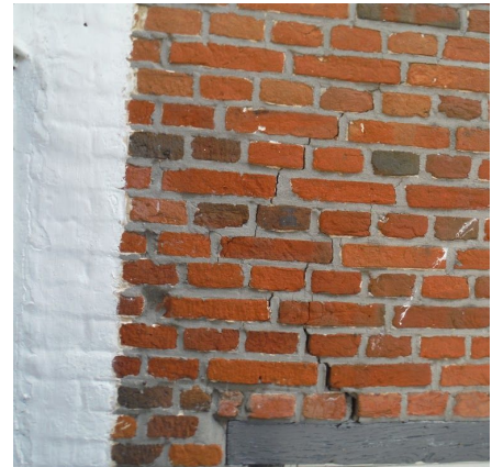
Scheurvorming net boven de latei.
