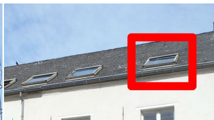
Dakraam dat niet meer wind- en waterdicht sluit.
