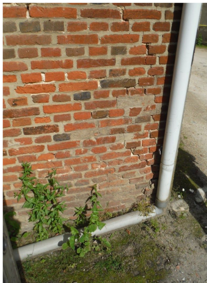
Diagonale scheuren in de noordelijke hoek.
