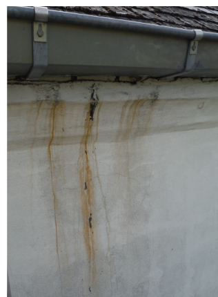
Vervolgschade op het pleisterwerk.
