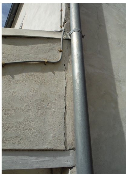
Scheurvorming in aansluiting met vleugel [1].
