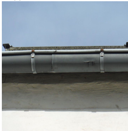
Mogelijk lek in de goot van dak [1]-oost.
