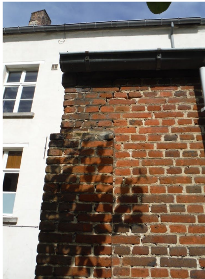
Scheurvorming zuidoostelijke hoek.
