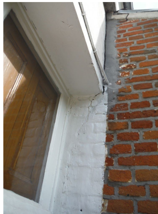
Scheurvorming in aansluiting met vleugel [1].
