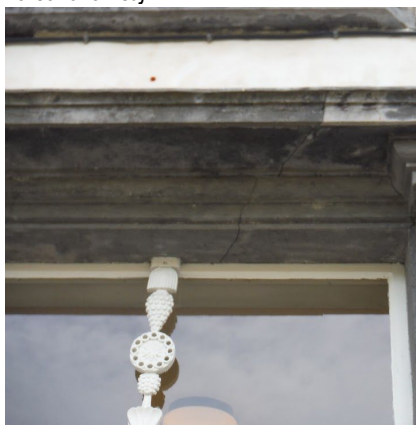
Gebarsten bovenste plaat.
