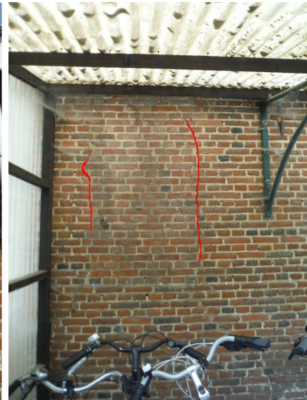
Scheurvorming invulmetselwerk noordoostelijke gevel.
