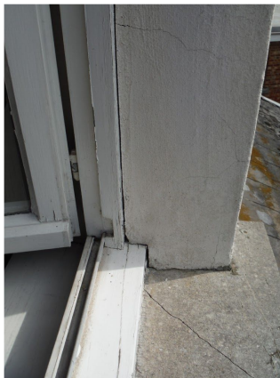
Openstaande voeg tussen dagkant en kozijn.
