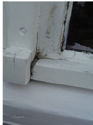
Lichte inrottingen op plaatsen waar vocht blijft staan.
