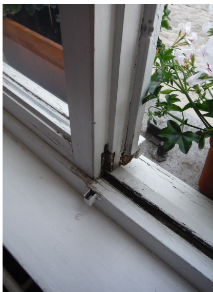
De inrotting aan de binnenzijde van het raam.
