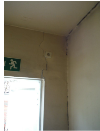
Scheurvorming in de binnenzijde.
