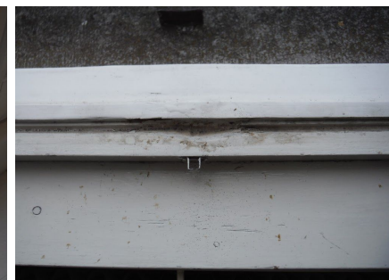
Inrotting door slechte afvoer van condenswater.
