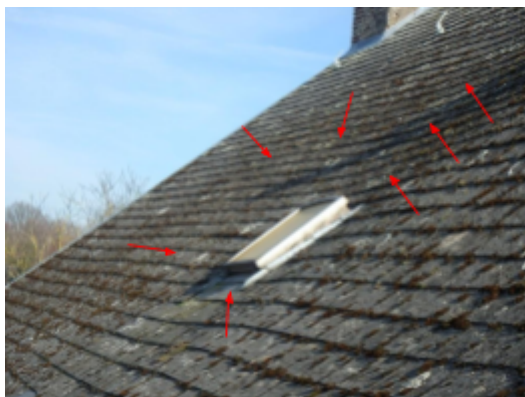
De aansluiting met het dakraam is niet optimaal, het dak buigt door
