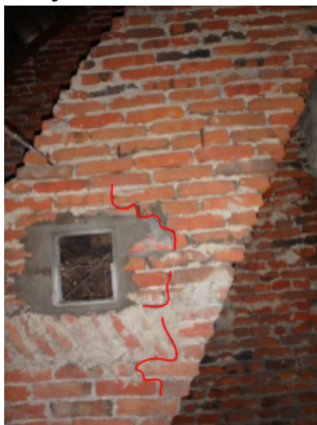
Schoorsteenmantel op zolder ingescheurd
