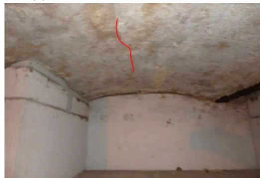
Scheurvorming in het gewelf
