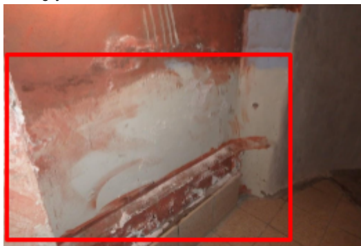
Waterdichte bekuiping wordt weggedrukt
