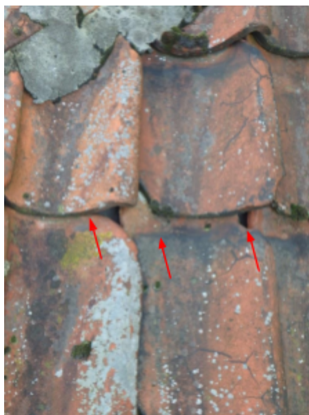
Pannen sluiten onvoldoende aan en zakken uit
