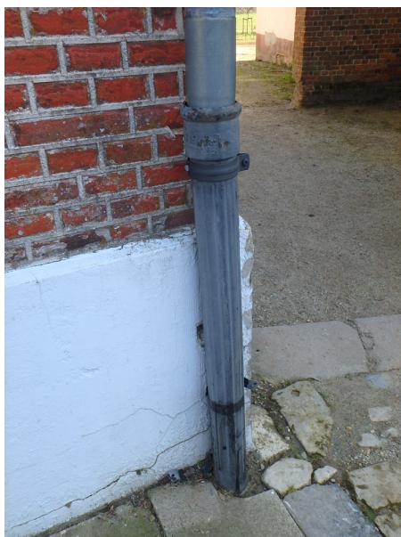
Standpijp begint te roesten
