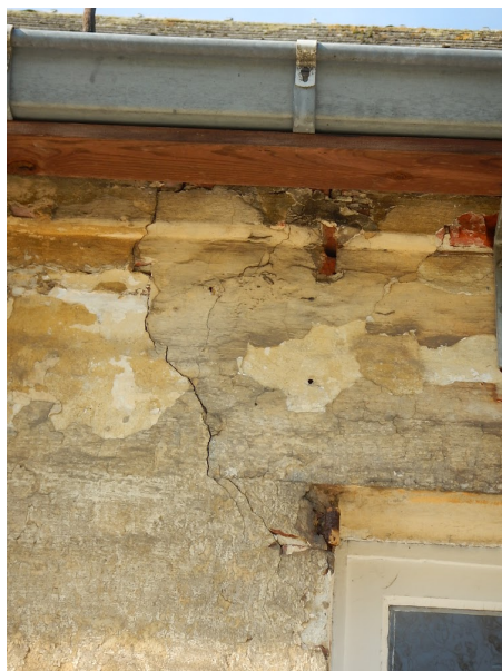
Vleugel [1]-achtergevel: scheurvorming
