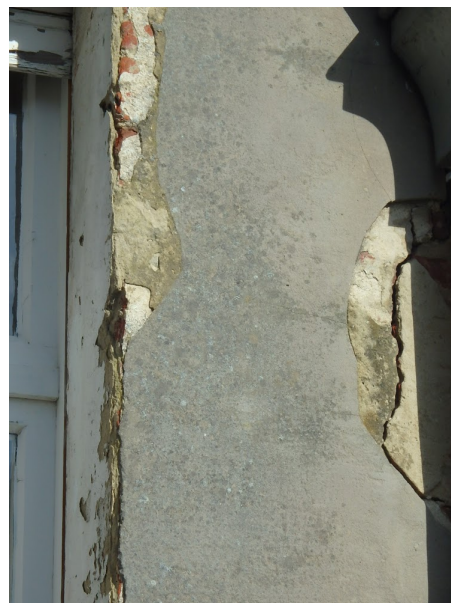
Vleugel [1]-zuid: pleisterwerk valt weg
