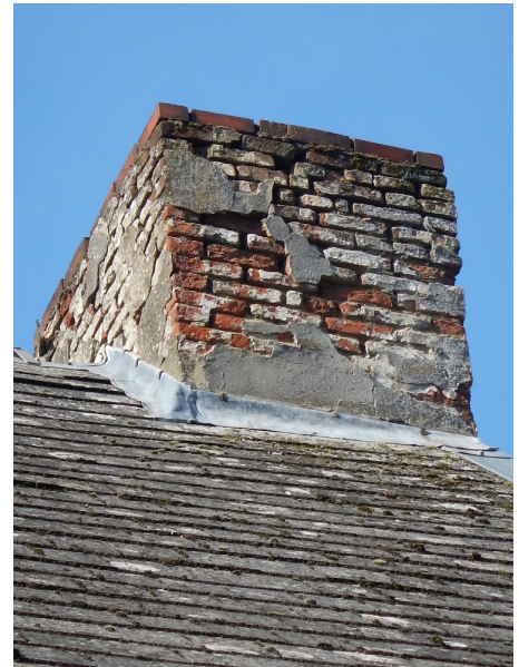
Sterk uitgespoeld voegwerk en los liggende stenen
