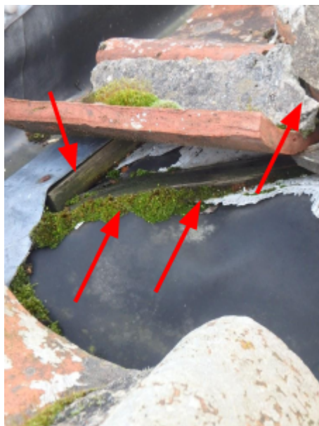
Mortelaansluiting scheurt en panlat ingerot
