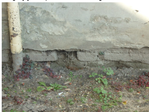
Vleugels [1]-zuid en [4]-zuid: voegwerk fundering is uitgespoeld
