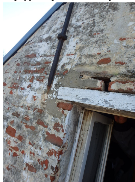
Vleugel [1]-noord: schilderwerk bladdert af en uitgespoeld voegwerk
