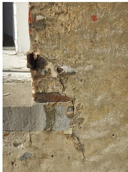
Vleugel [1]-achtergevel: scheurvorming
