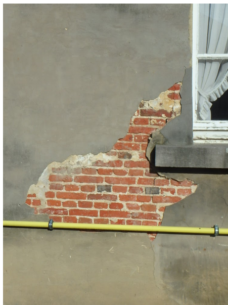
Vleugel [1]-zuid: pleisterwerk valt weg
