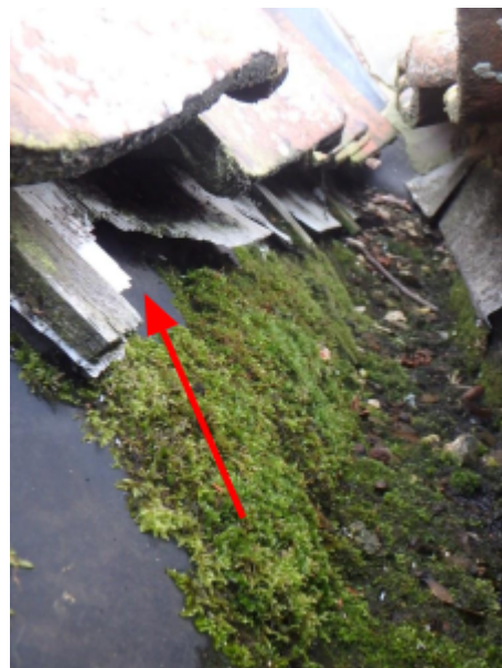
Onderdak is aangetast door ultraviolet stralen
