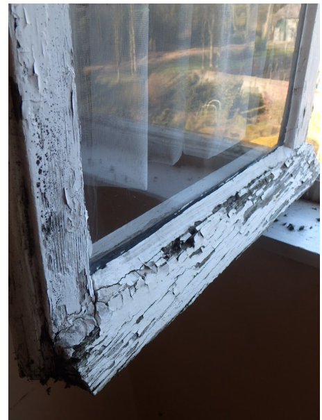
Sterk verweerde waterlijst
