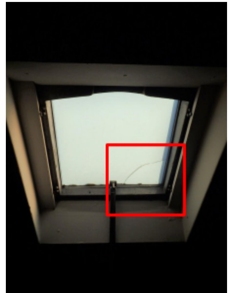
Het glas is gebroken
