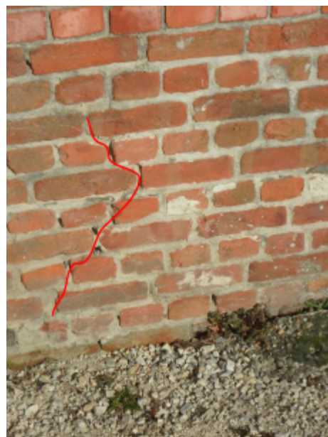
Vleugel [4]-zuid: lichte scheurvorming
