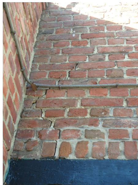
Vleugel [2]-achterdeur: scheurvorming boven houten deurlatei
