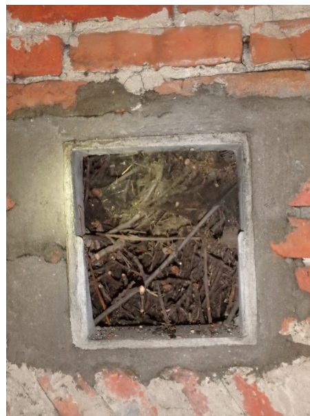
Takken in het schoorsteenkanaal
