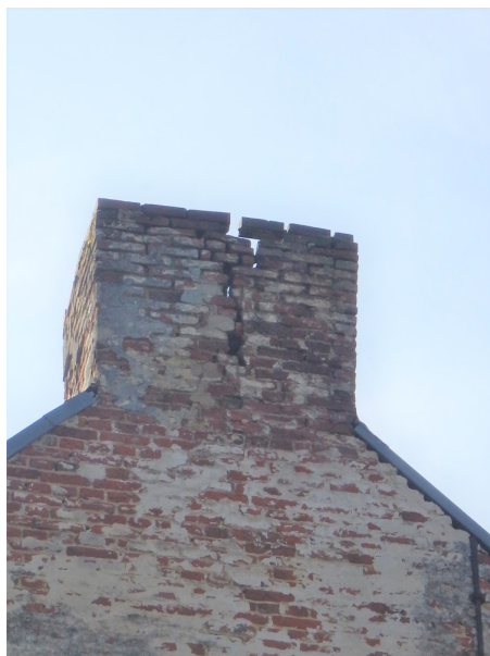
Sterk ingescheurde schoorsteen
