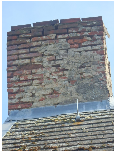
Sterk uitgespoeld voegwerk en los liggende stenen
