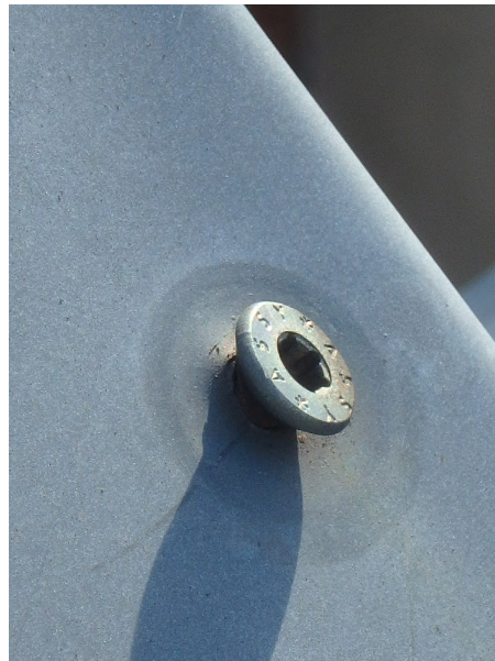
De dakrand is onvoldoende diep bevestigd
